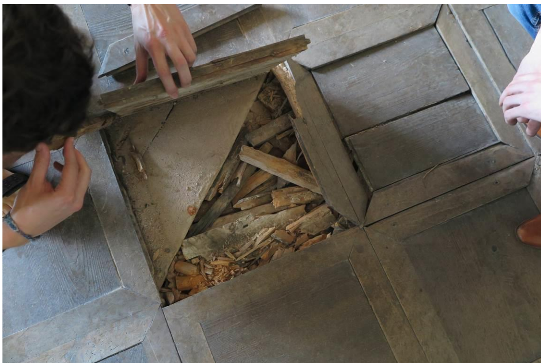
Obr. 10 a 11 Klášter Broumov, knihovni sál – nedestruktivní průzkum stavu dřevěných podlah, vyžadujících odborný zásah. Foto: Martina Bolom-Kotari (2016).
