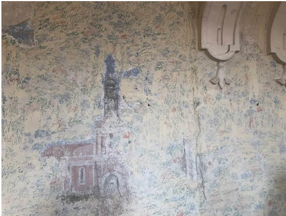
Obr. 1. Klášter Police nad Metují, Laudonův sál – důsledky neodborného odkrývání historických omítkových vrstev. Foto: Sixtus Bolom-Kotari (2019).
