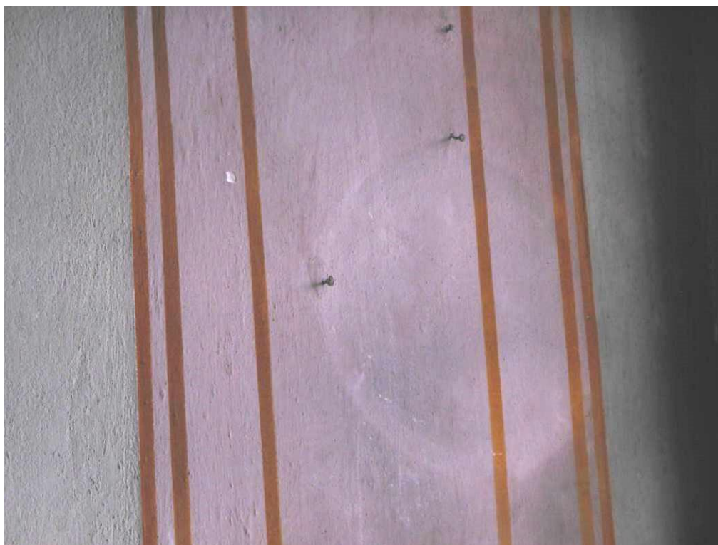
Obr. 8. Klášter Broumov, knihovni sál – v některých případech prozradí umístění a orientační podobu historického vybavení knihovny hřebíky a obrysy v omítce. Foto: Sixtus Bolom-Kotari (2016).
