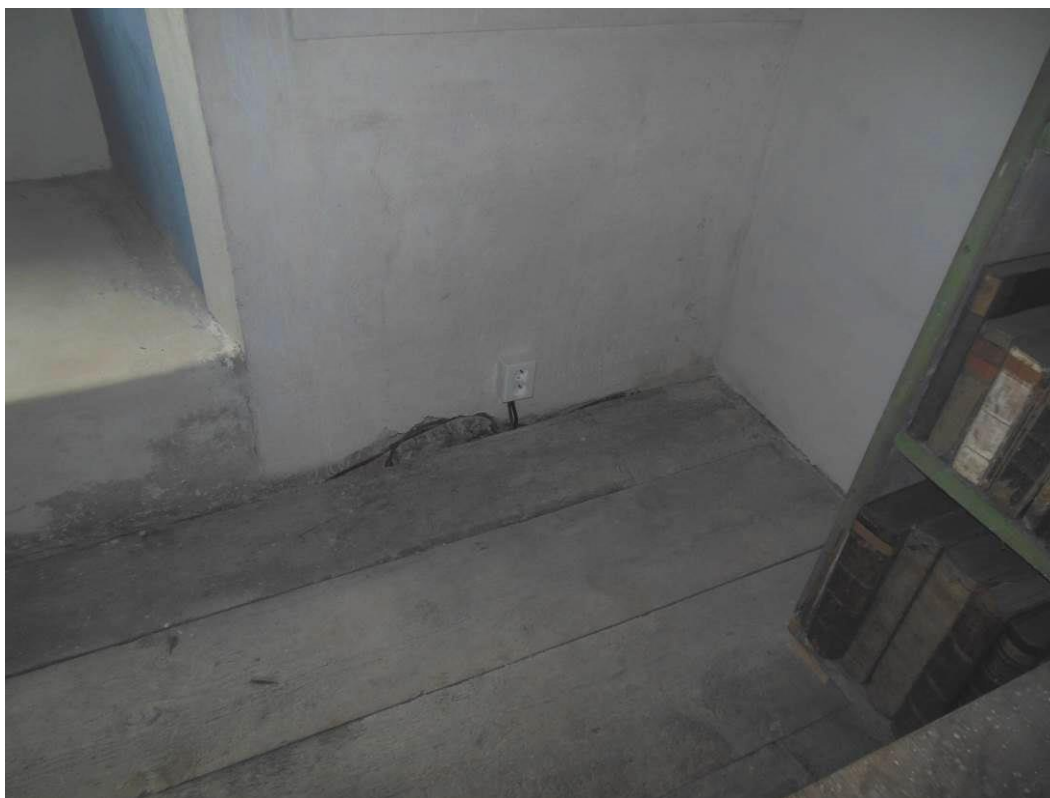
Obr. 21 a 22. Klášter Broumov – knihovni sál, detaily řešení elektroinstalace dostatečně nezohledňující památkové hodnoty místa, ať už použitím prefabrikátů (vypínače, zásuvky) či způsobem vedení rozvodů, kterému nebyla věnována žádná pozornost. Foto: Sixtus Bolom-Kotari (2016).
